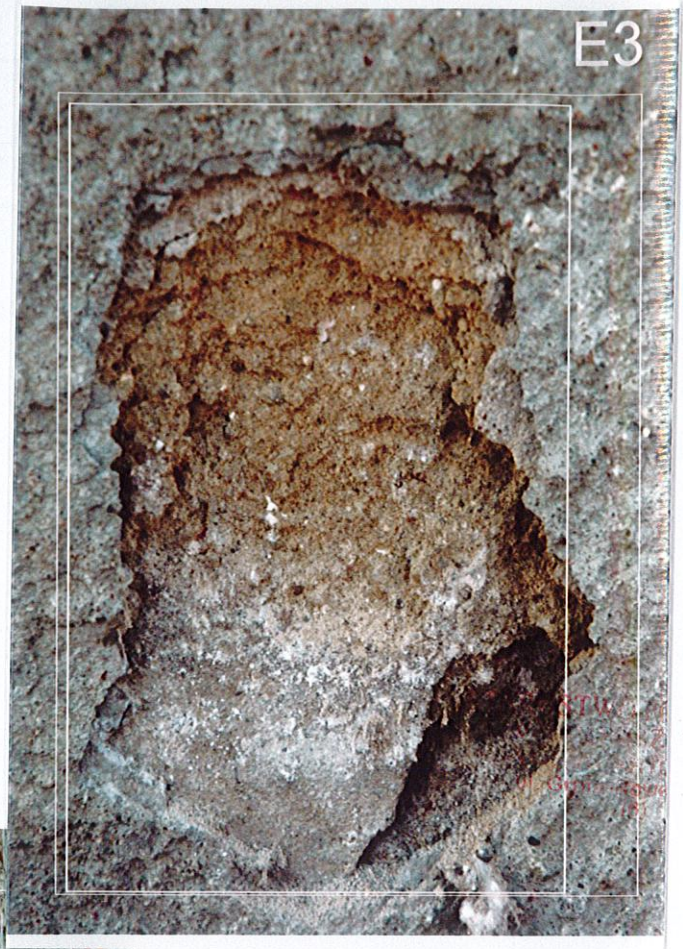
Odkrywka E3. Brak oryginalnych wymalowań tynków.
