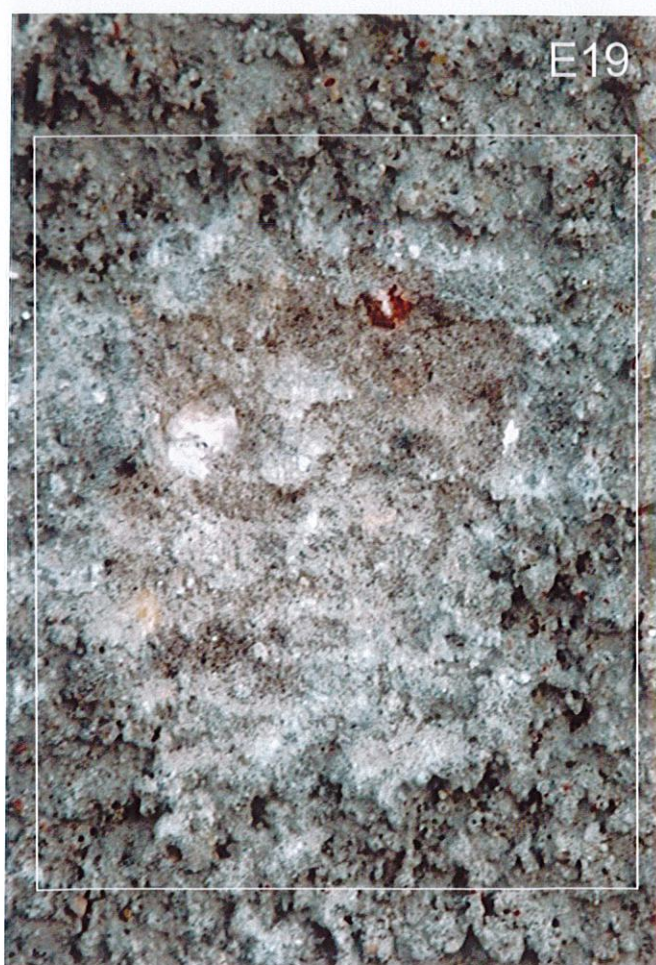
Odkrywka E19. Brak oryginalnych wymalowań tynków.
