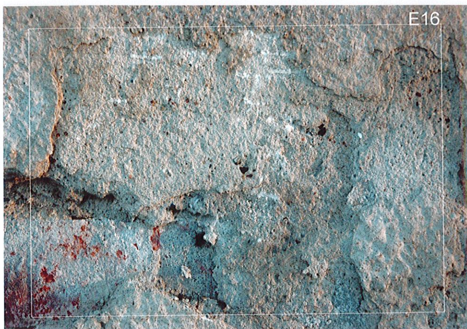
Odkrywka E16. Brak oryginalnych wymalowań tynków.
