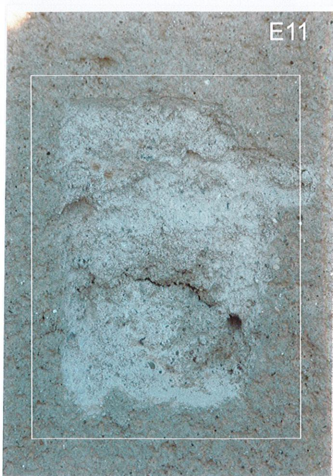
Odkrywka E11. Brak oryginalnych wymalowań tynków.
