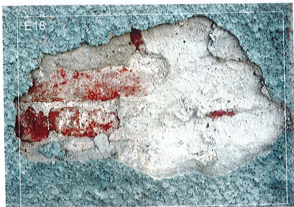
Odkrywka E18. Brak oryginalnych wymalowań tynków.
