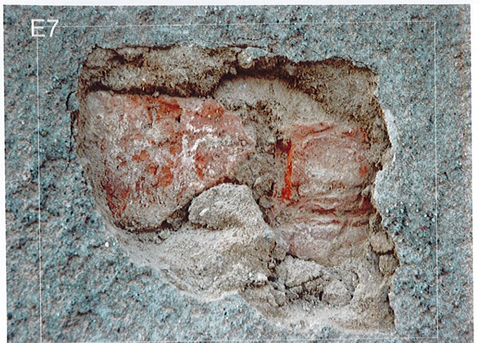
Odkrywka E7. Brak oryginalnych wymalowań tynków.
