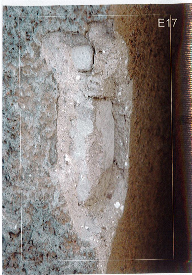
Odkrywka E17. Brak oryginalnych wymalowań tynków.
