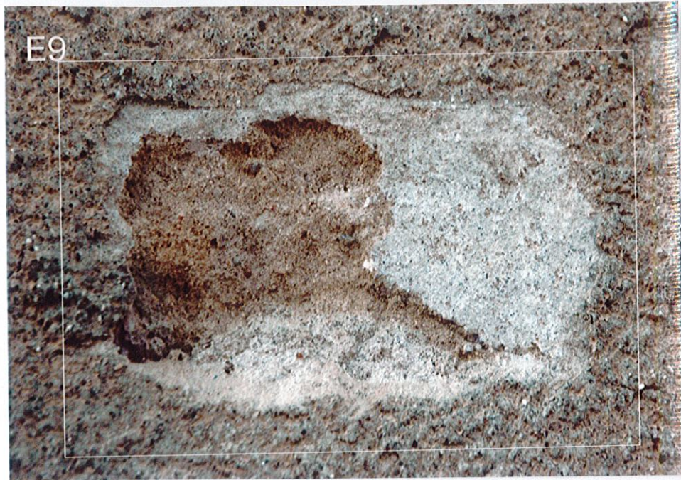
Odkrywka E9. Brak oryginalnych wymalowań tynków.
