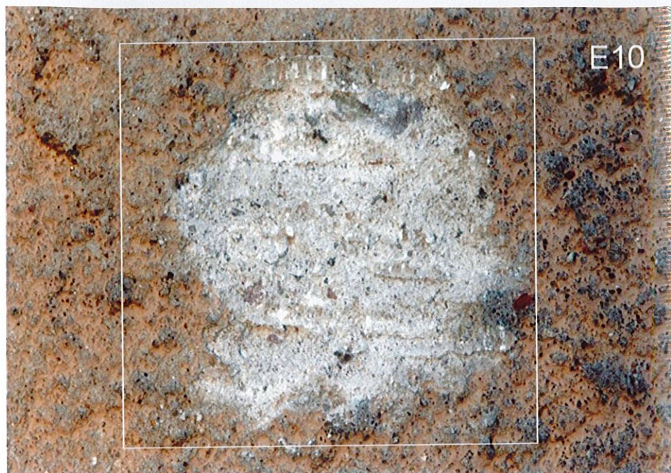
Odkrywka E10. Brak oryginalnych wymalowań tynków.
