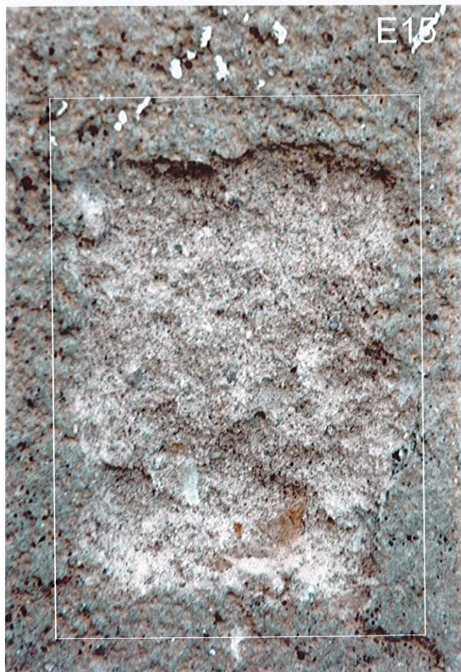
Odkrywka E15. Brak oryginalnych wymalowań tynków.
