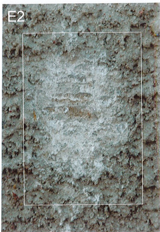
Odkrywka E2. Brak oryginalnych wymalowań tynków.
