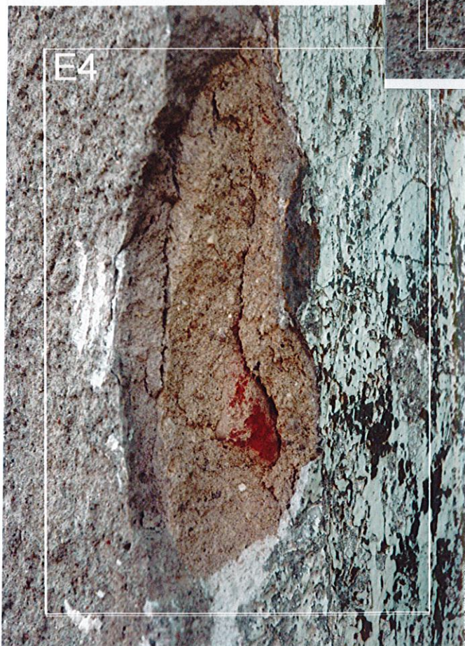
Odkrywka E4. Brak oryginalnych wymalowań tynków.
