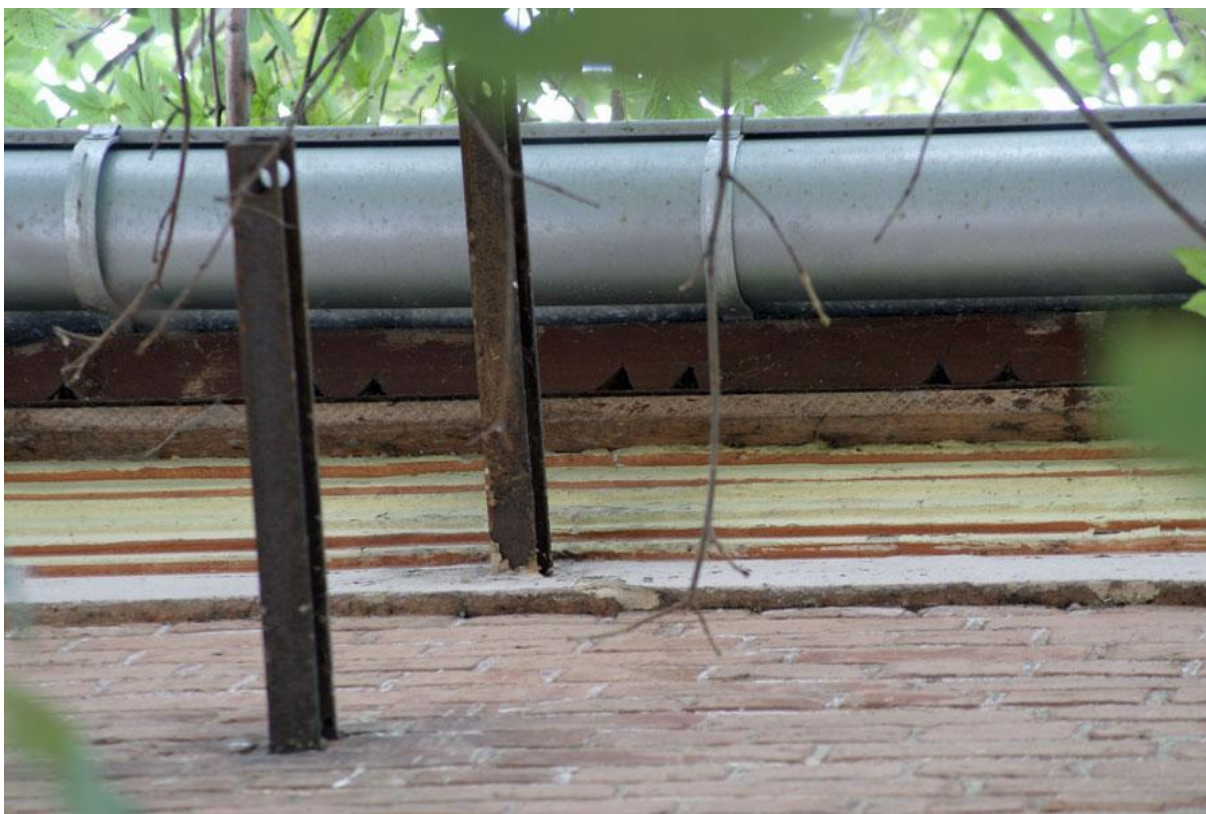
Elewacja południowo-zachodnia budynku. Widoczne relikty opracowania barwnego. (Fot. J. Strużyński, wrzesień 2013 r.)
