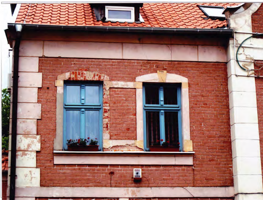
Fot. 22. Elewacja frontowa, okna na piętrze po lewej stronie ryzalitu. Widoczne ubytki wypraw oraz ukośne pęknięcia
