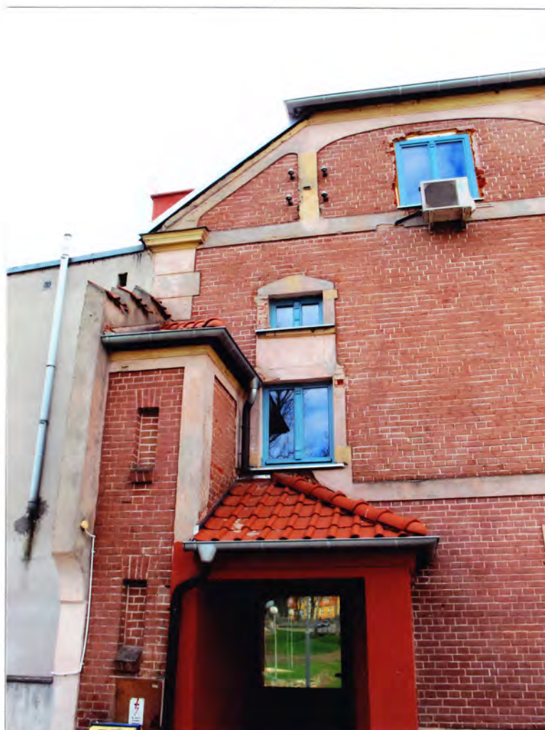
Fot. 21. Elewacja północno-wschodnia. Widoczne zniszczenia i ubytki tynkowanych detali oraz wtórnie wybity otwór okienny w szczycie.
