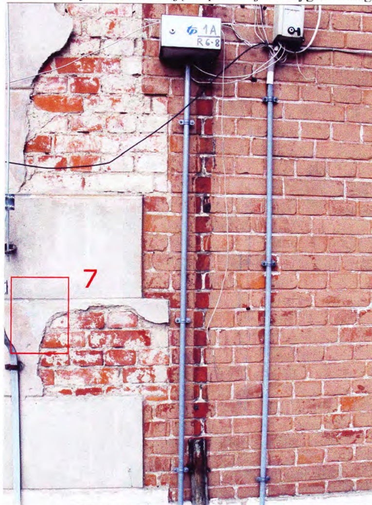
Fot. 18. Fragment boniowania na elewacji południowo-zachodniej, miejsce wykonania odkrywki nr 7. W miejscu dawnego przebiegu przewodów instalacji widoczny fragment wątku ceglanego bez wtórnej warstwy malarskiej
