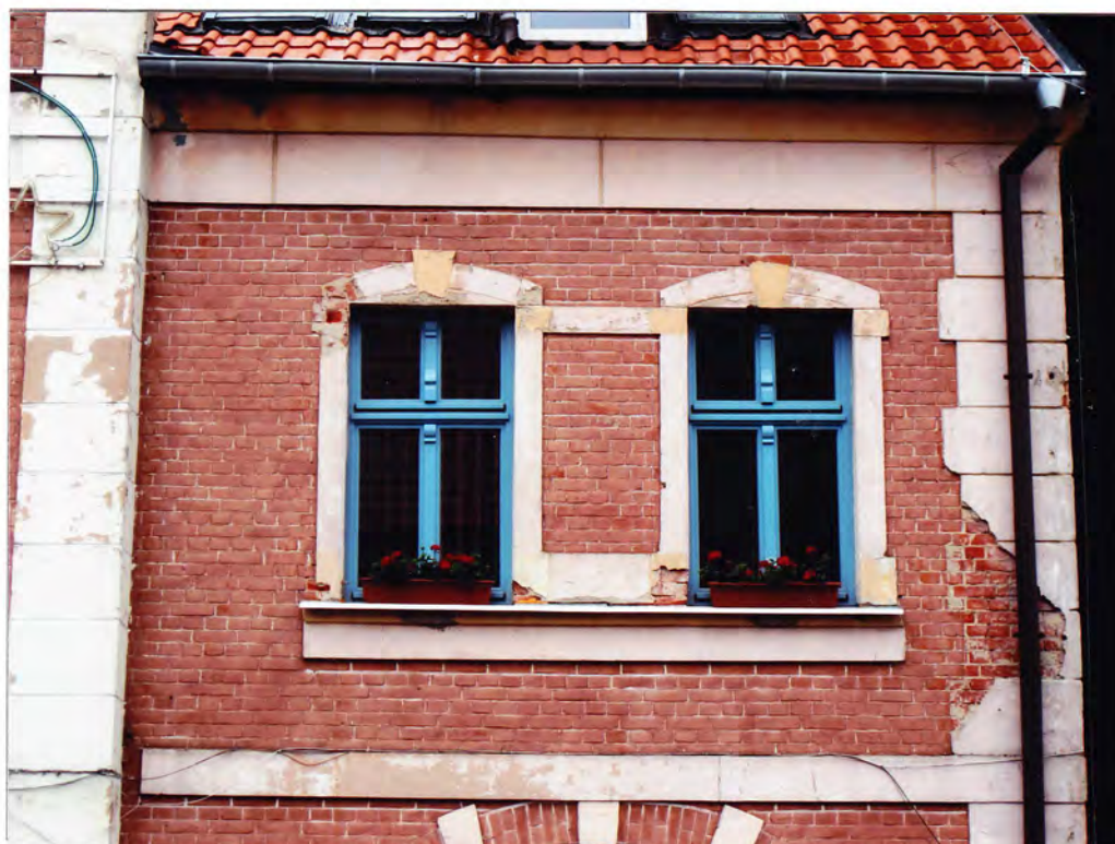
Fot. 23. Elewacja frontowa, okna na piętrze po prawej stronie ryzalitu. Widoczne ubytki wypraw
