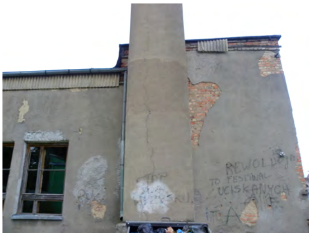
Fot.8. Zarysowanie trzonu zew.
