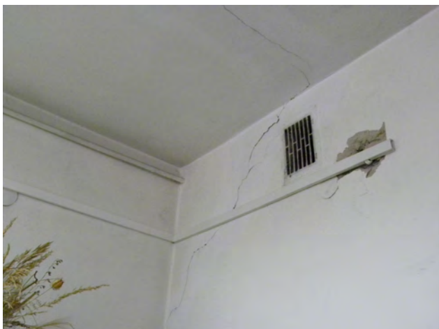
Fot.7. Zarysowanie trzonu wew.
