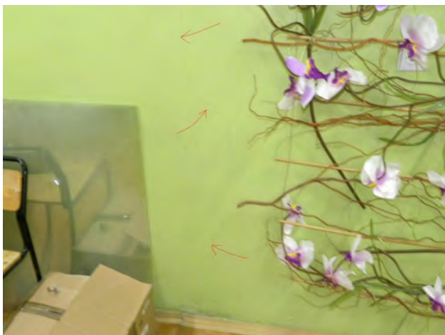
Fot.5. Rysa pionowa ściany nośnej
