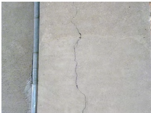
Fot.9. Zarysowanie trzonu zew.
