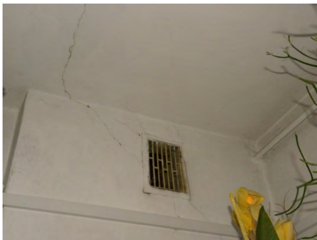
Fot.6. Zarysowanie trzonu wew.
