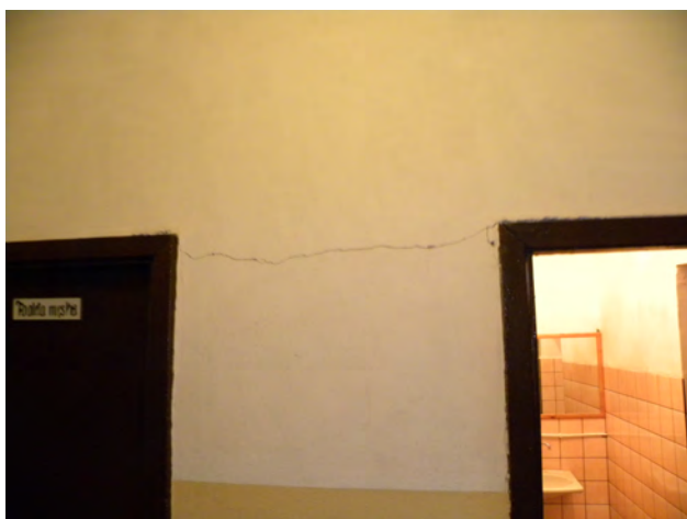
Fot.4. Rysa pozioma ściany nośnej
