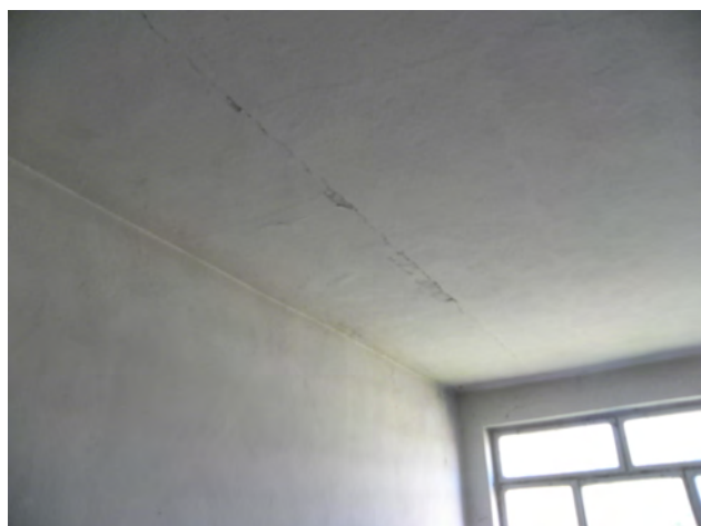
Fot.3. Charakterystyczne zarysowanie podłużne stropu
