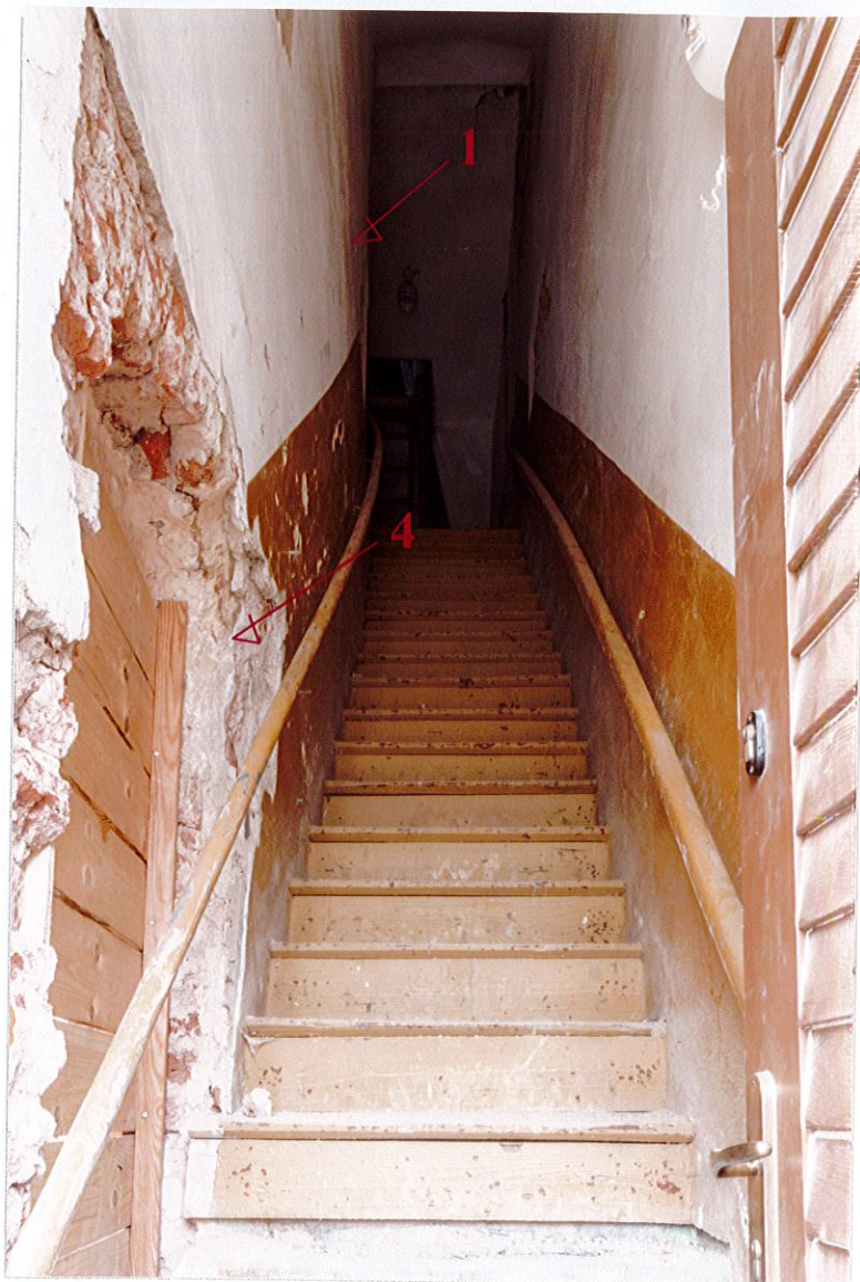
Fot. 3. Wnętrze klatki schodowej. Schody prowadzące na piętro wykonano podczas remontu w 1959 roku. Pokrywa je warstwa betonu, którą później (podczas kolejnego remontu) przykryto drewnianymi stopnicami i podstopnicami. Po lewej stronie widoczne odkryte w 2014 roku przejście z przejazdu bramnego oraz zachowane na ościeżu tynki (próbka nr 4). Na szczycie schodów, na ścianie po lewej stronie w odkrywce architektonicznej w miejscu innego, obecnie zamurowanego przejścia również zachowały się tynki (próbka nr 1). Dodatek cementu dowodzi, iż położone zostały podczas kiedy brama pełniła funkcję więzienia (od końca XIX w.).
