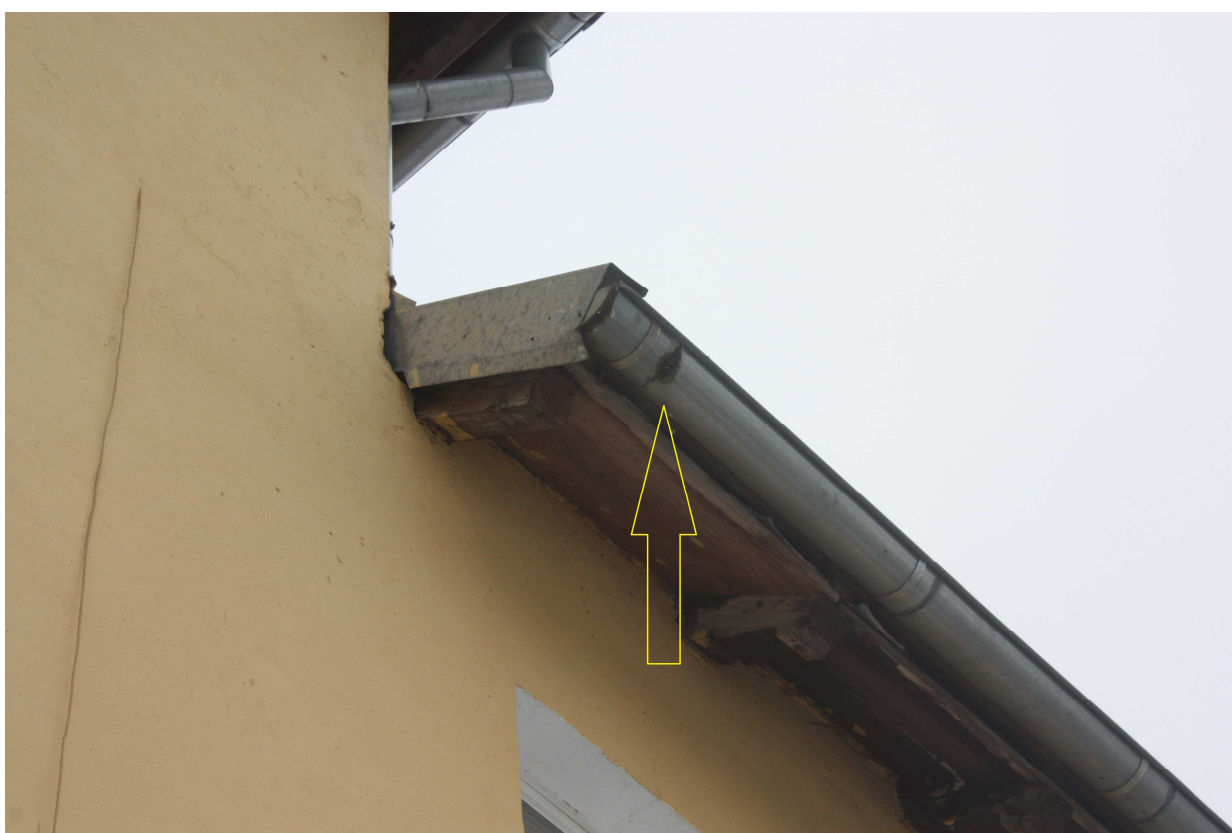
Zdjęcie nr 23 – Skorodowana rynna na części C
