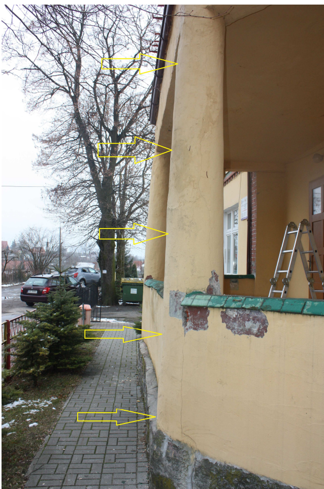
Zdjęcie nr 18 – Odchylenie słupa tarasu od pionu
