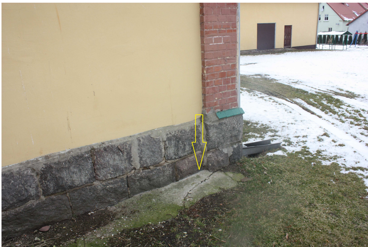
Zdjęcie nr 12 – Pęknięcia opaski betonowej
