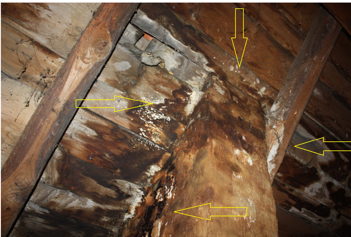
Zdjęcie nr 27 – Korozja biologiczna i zawilgocenie kominów oraz deskowania na części C
