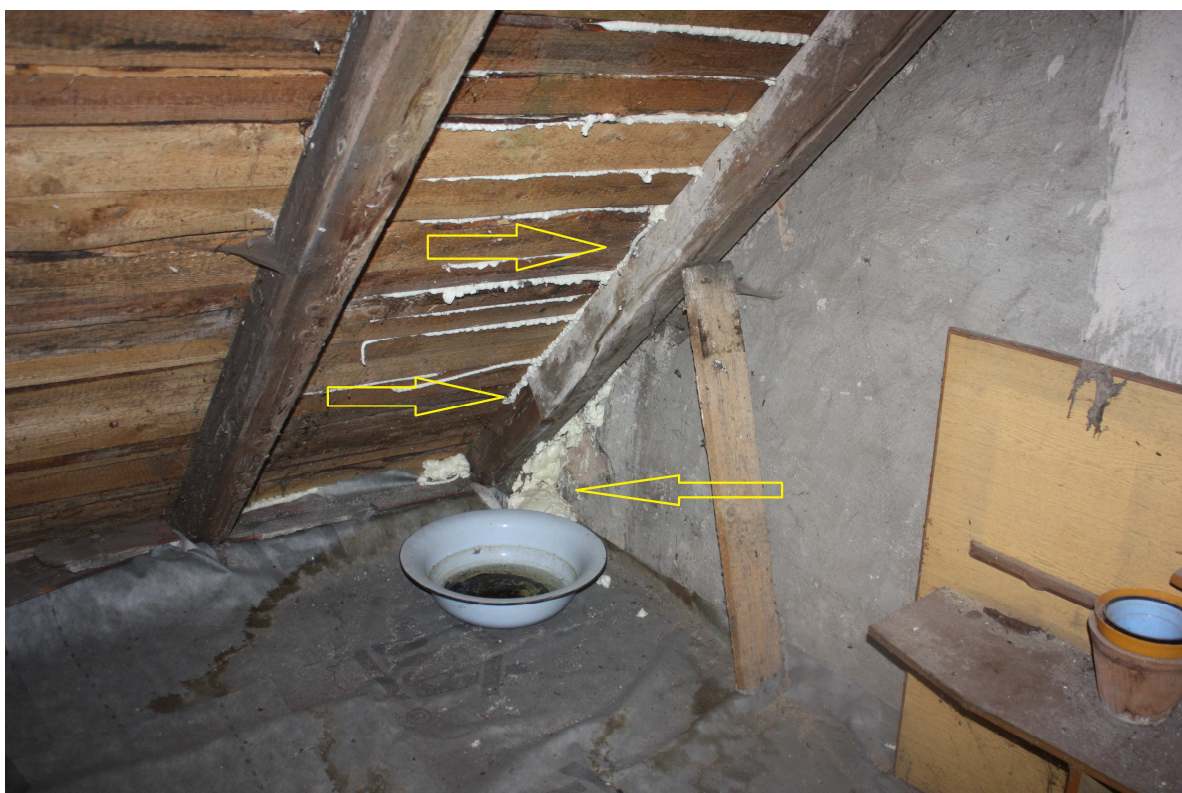
Zdjęcie nr 29 – Zacieki na połaci oraz korozja więźby na części A spowodowane błędnym wykonaniem obróbek
