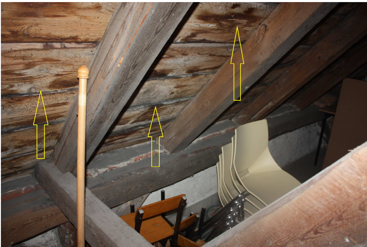
Zdjęcie nr 26 – Korozja biologiczna i zawilgocenie deskowania połaci na części C
