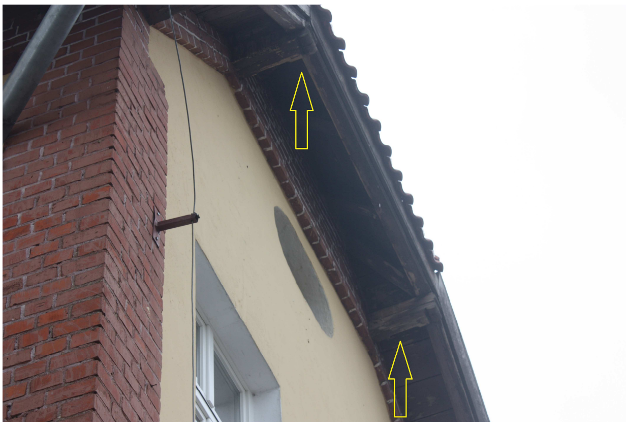
Zdjęcie nr 22 – Skorodowane elementy okapów
