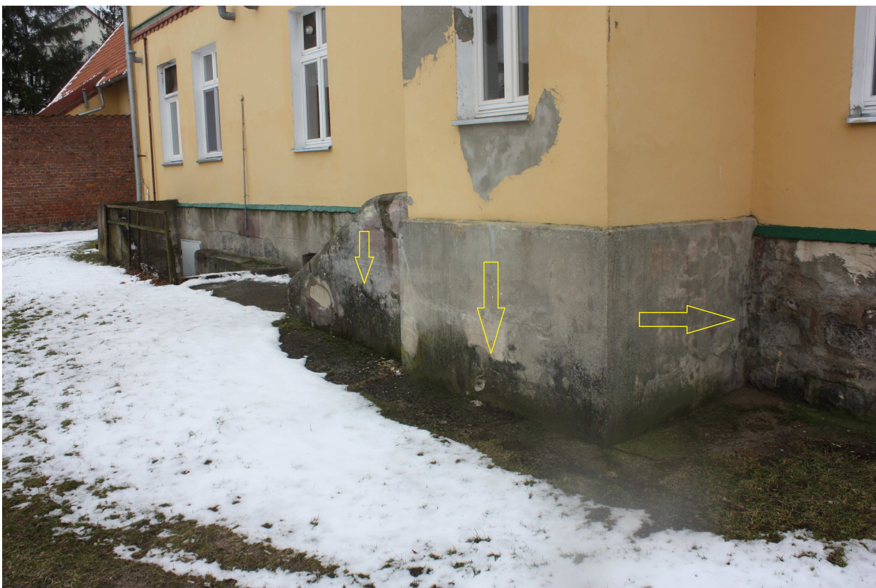
Zdjęcie nr 07 – Podsiąknięcia wody na części A od strony północnej
