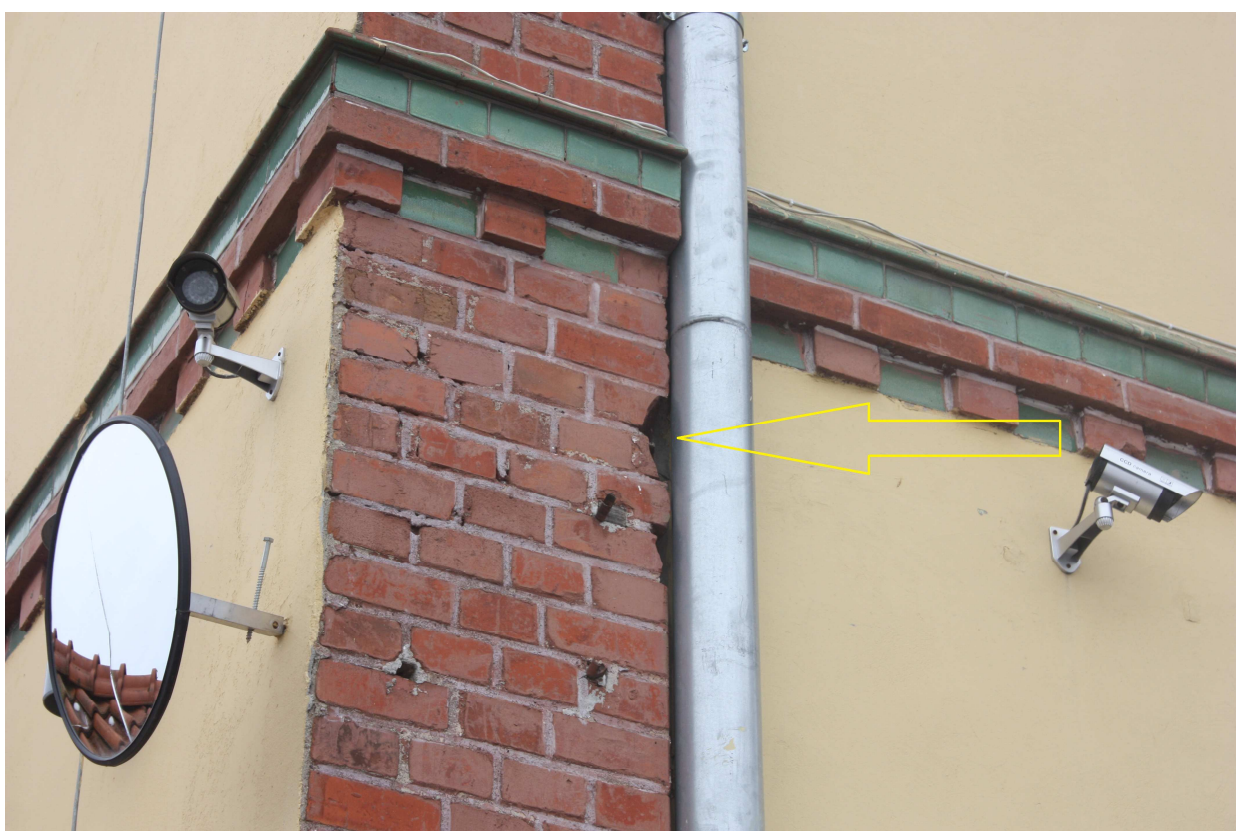
Zdjęcie nr 21 – Pęknięcia i odspojenia cegieł na części A
