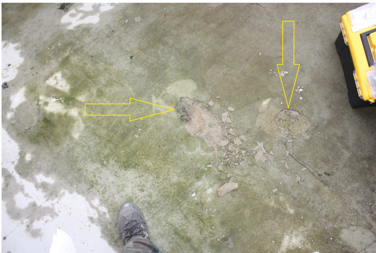
Zdjęcie nr 14 – Pęknięcia warstwy spadkowej na tarasie
