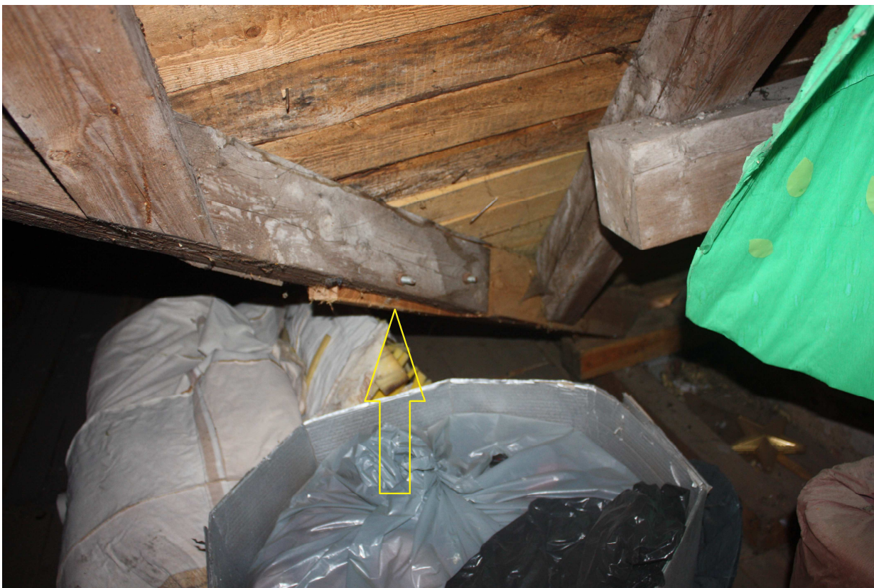
Zdjęcie nr 30 – Błędne wykonanie połączenia krokwi wzmacnianej krokwi koszowej
