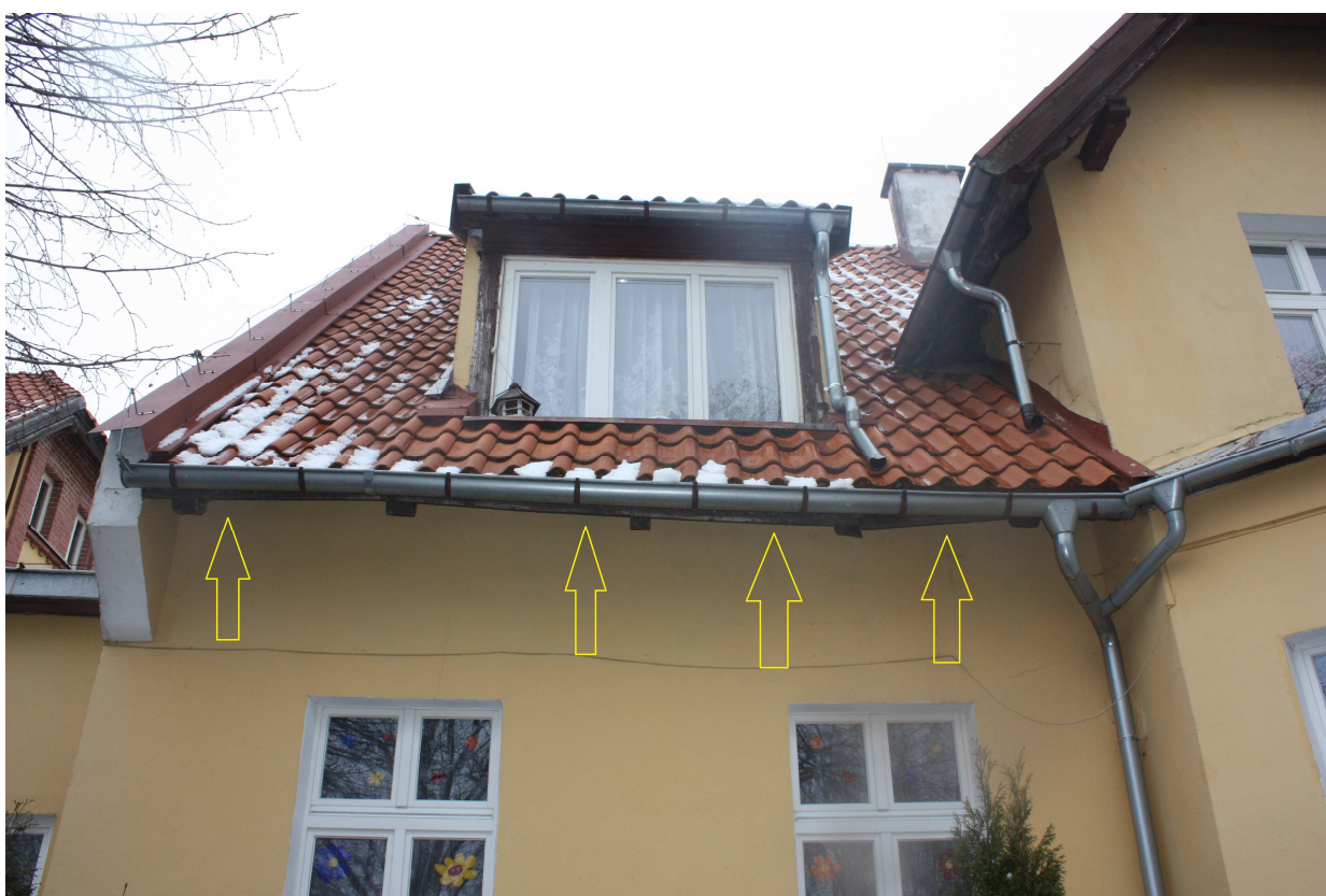
Zdjęcie nr 25 – Załamany okap na części C od strony południowej
