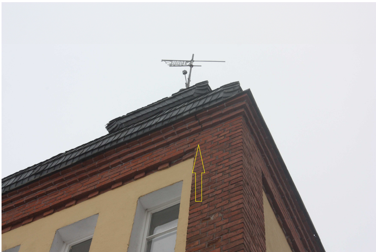
Zdjęcie nr 20 – Pęknięcie ściany zewnętrznej przy wieży
