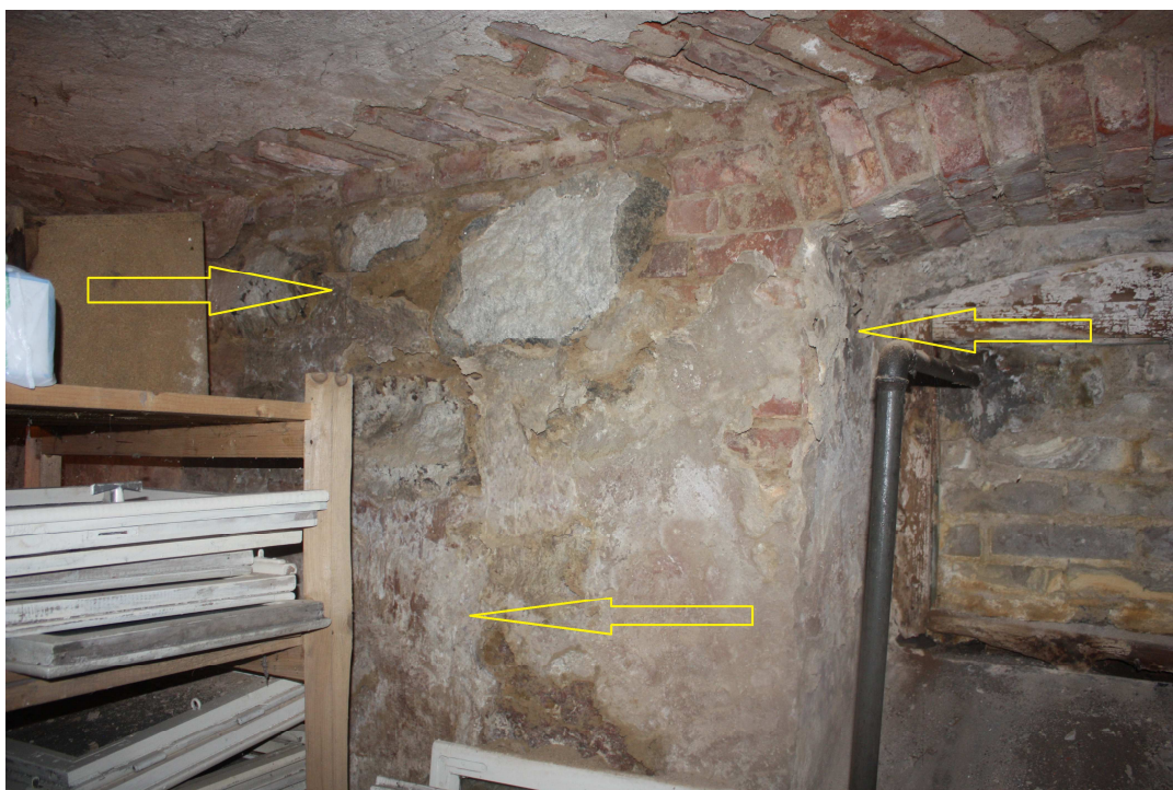
Zdjęcie nr 01 – Podsiągnięcia wody i korozja murów piwnicznych w części A
