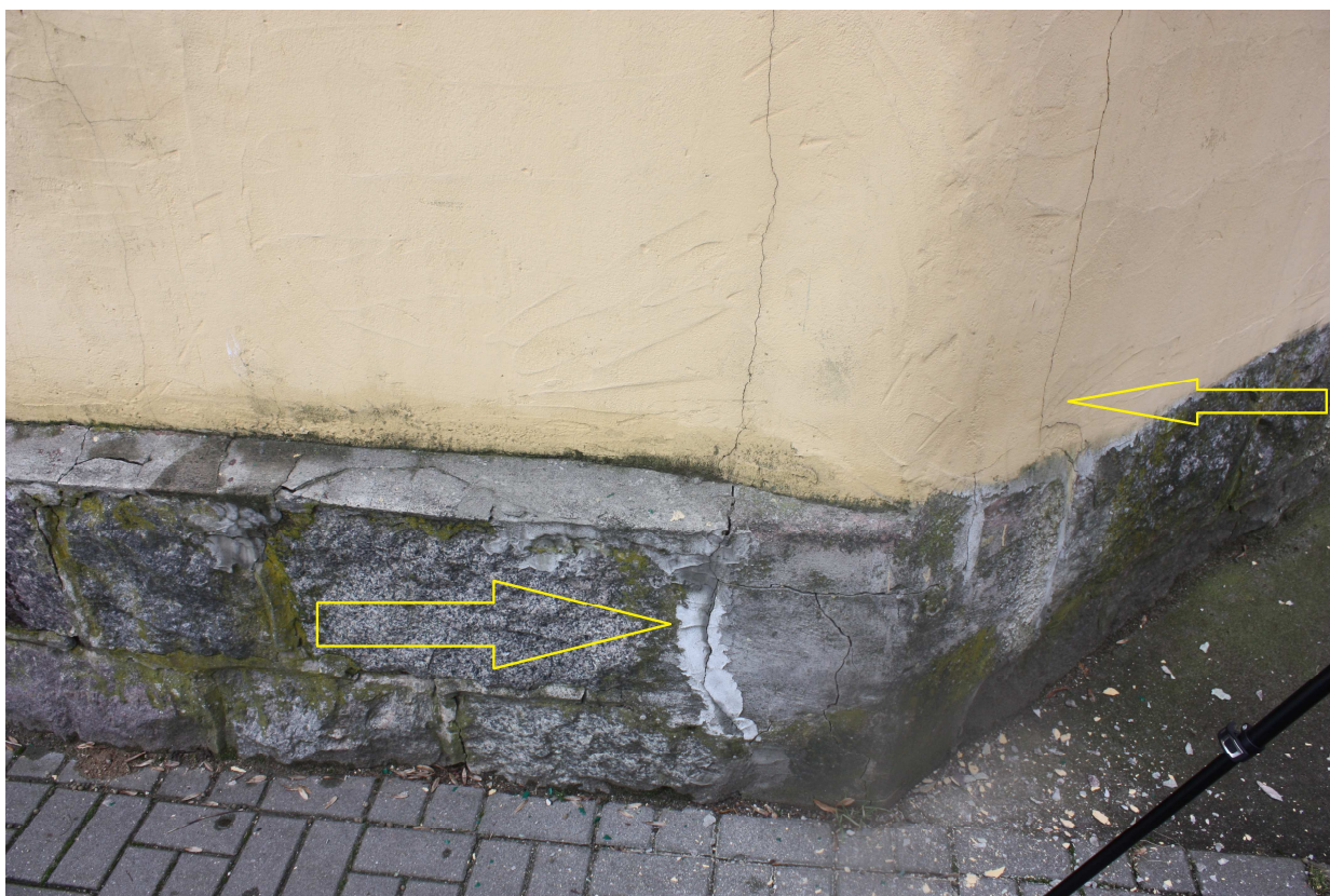
Zdjęcie nr 16 – Pęknięcia fundamentu podstawy słupa tarasu
