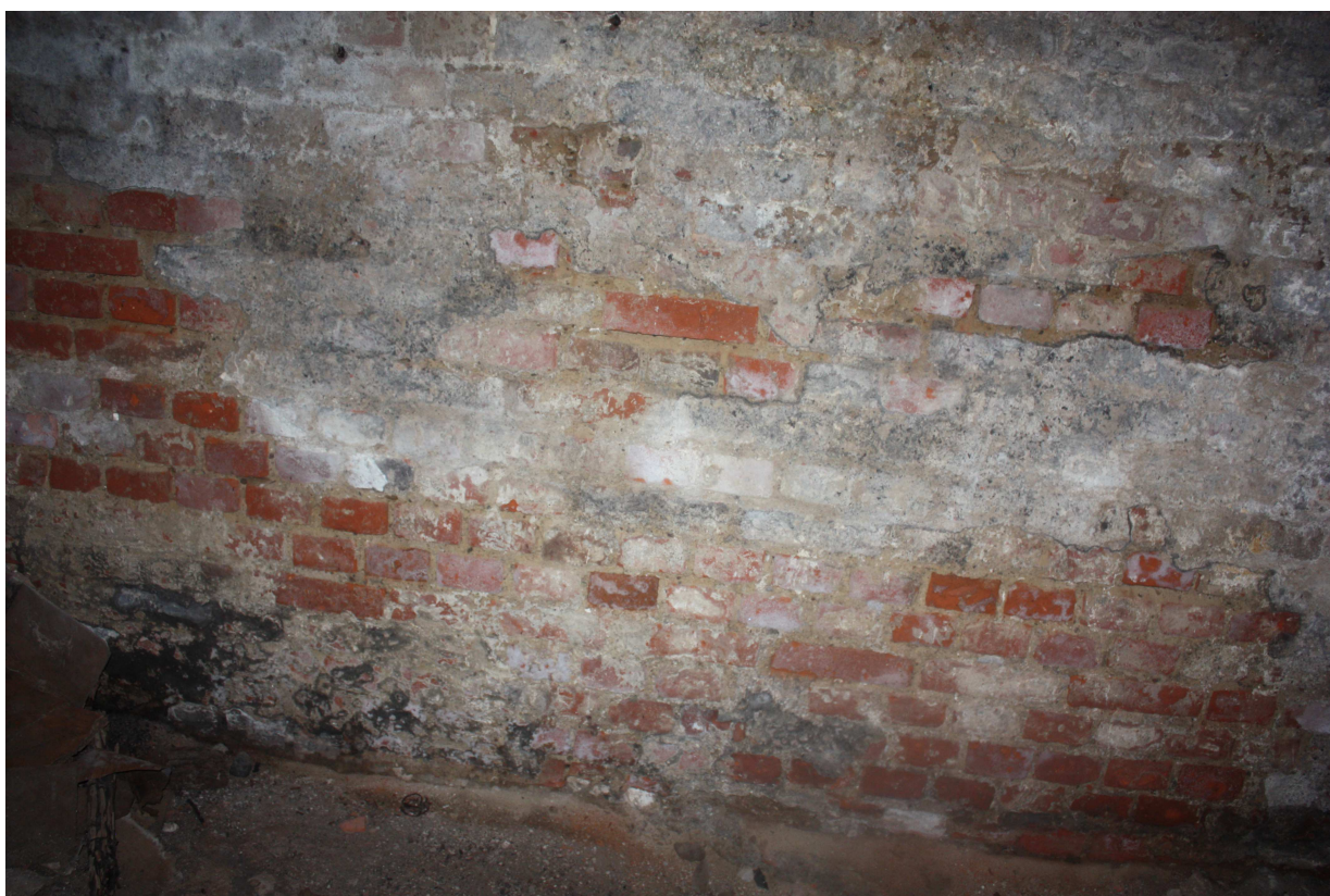
Zdjęcie nr 03 – Podsiąknięcia wody i korozja murów piwnicznych w części C
