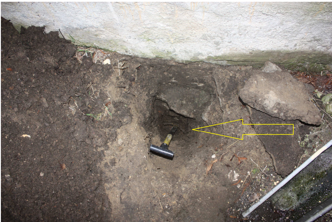
Zdjęcie nr 19 – Brak ławy fundamentowej w części B
