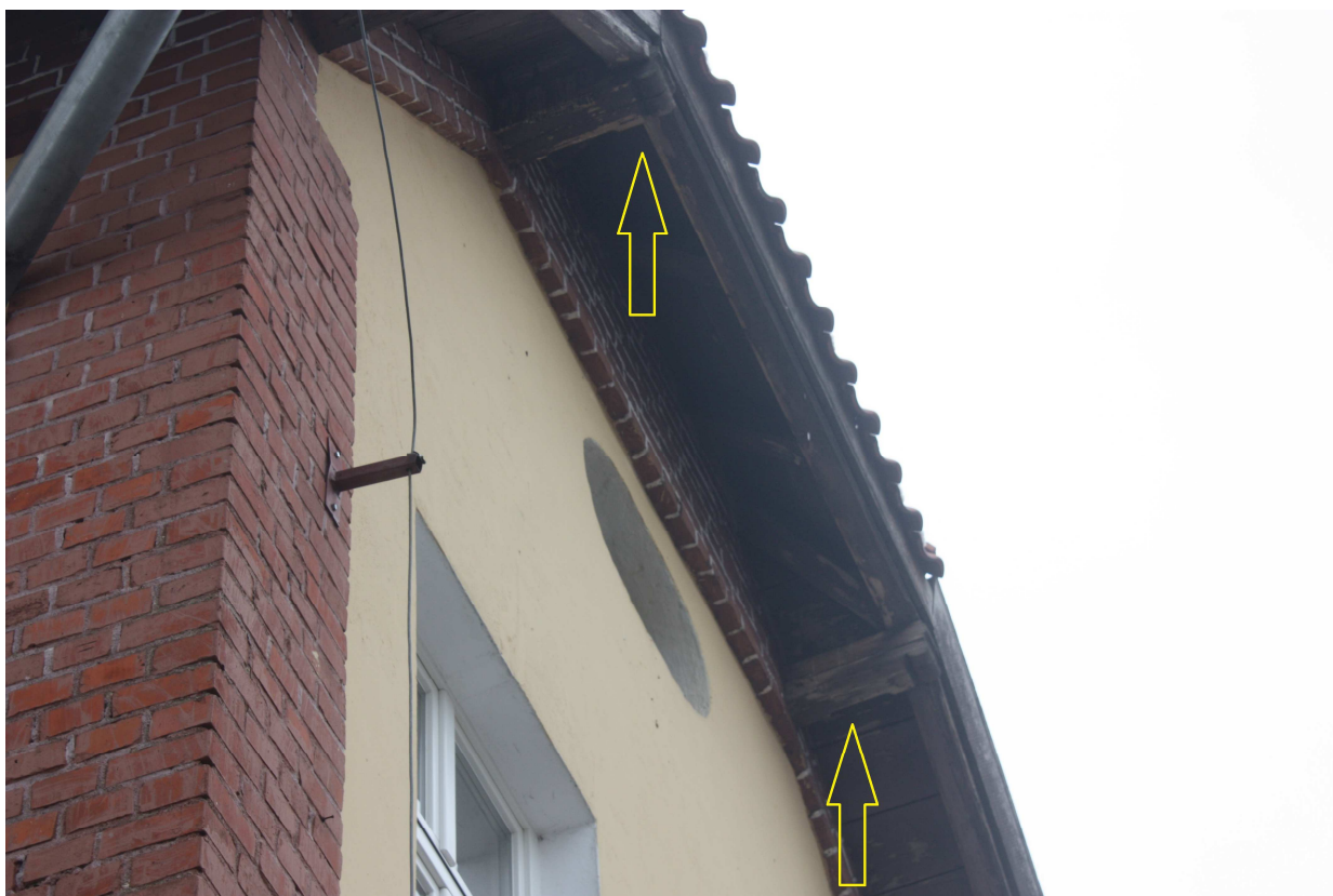
Zdjęcie nr 22 – Skorodowane elementy okapów
