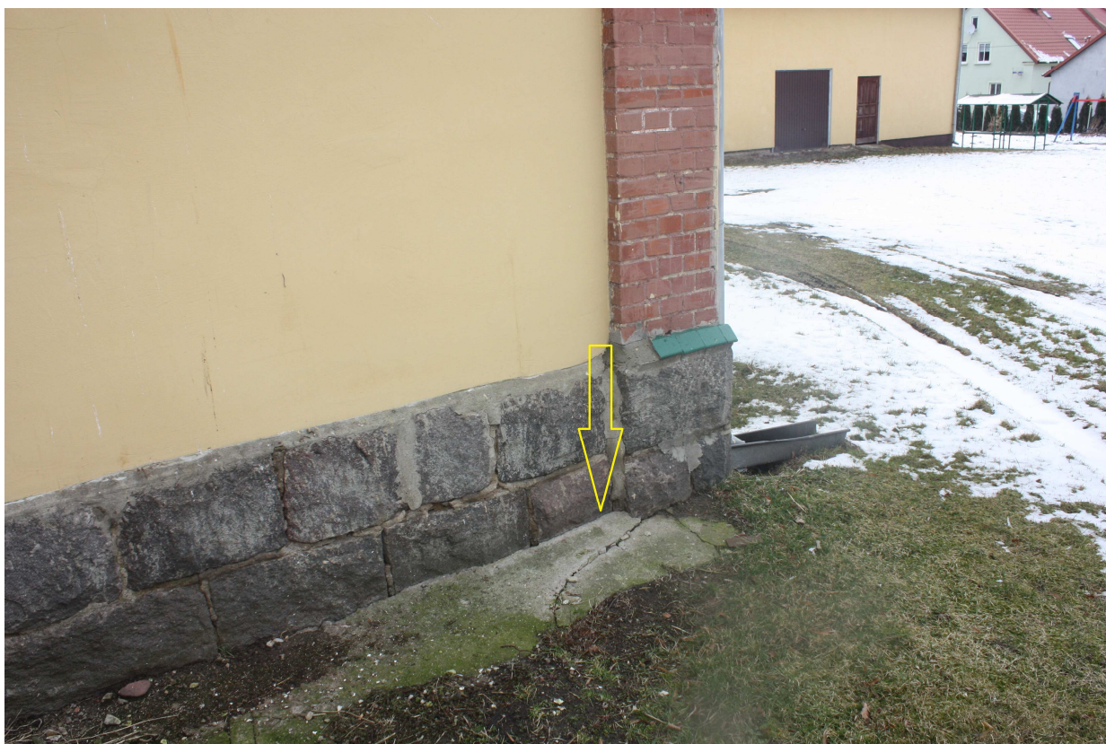
Zdjęcie nr 12 – Pęknięcia opaski betonowej
