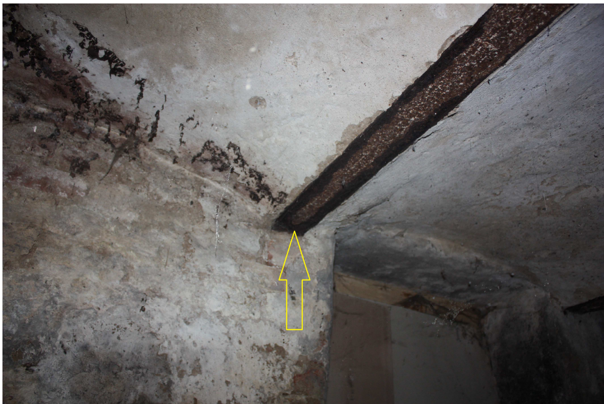
Zdjęcie nr 04 – Korozja belki stropu odcinkowego w części C
