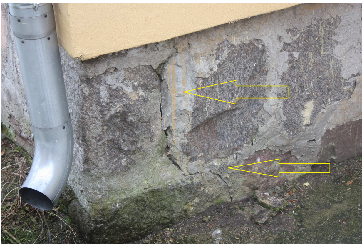
Zdjęcie nr 13 – Pęknięcia ściany fundamentowej na części C od strony północnej
