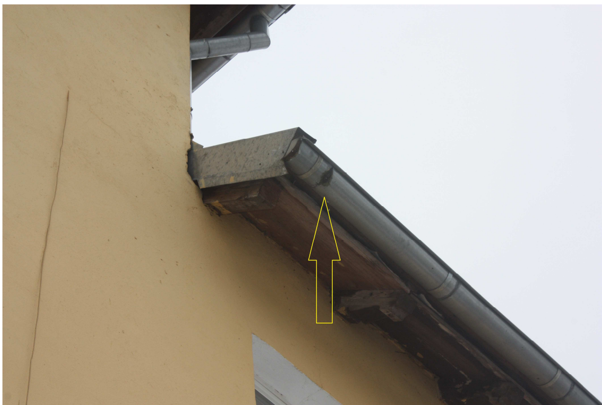
Zdjęcie nr 23 – Skorodowana rynna na części C
