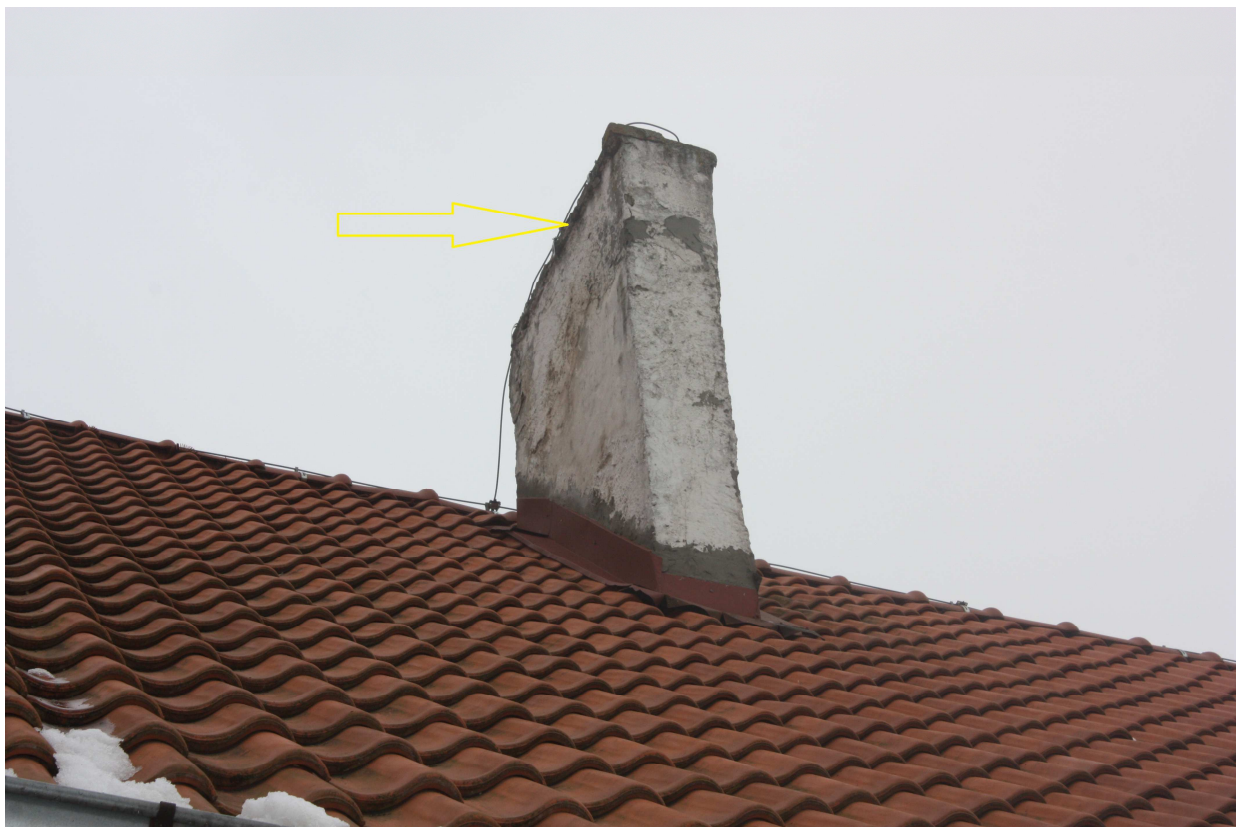
Zdjęcie nr 24 – Skorodowana czapka kominowa na części C
