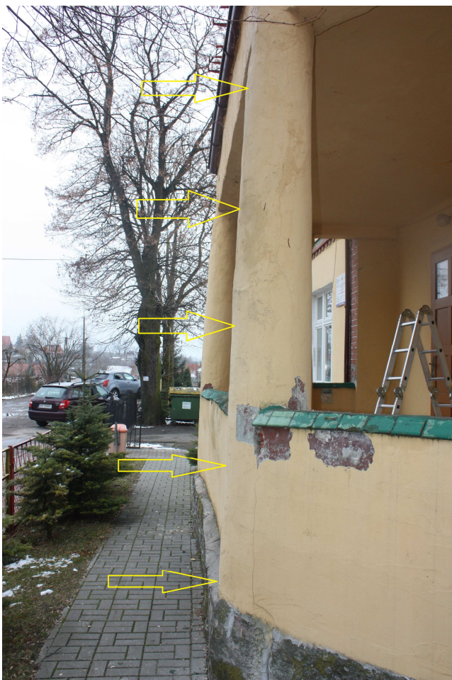
Zdjęcie nr 18 – Odchylenie słupa tarasu od pionu
