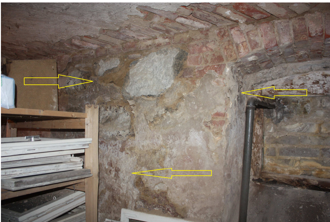
Zdjęcie nr 01 – Podsiąknięcia wody i korozja murów piwnicznych w części A
