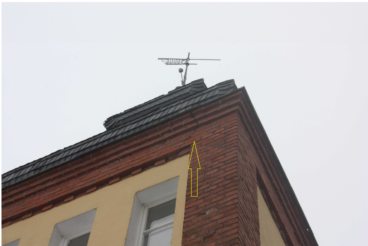
Zdjęcie nr 20 – Pęknięcie ściany zewnętrznej przy wieży
