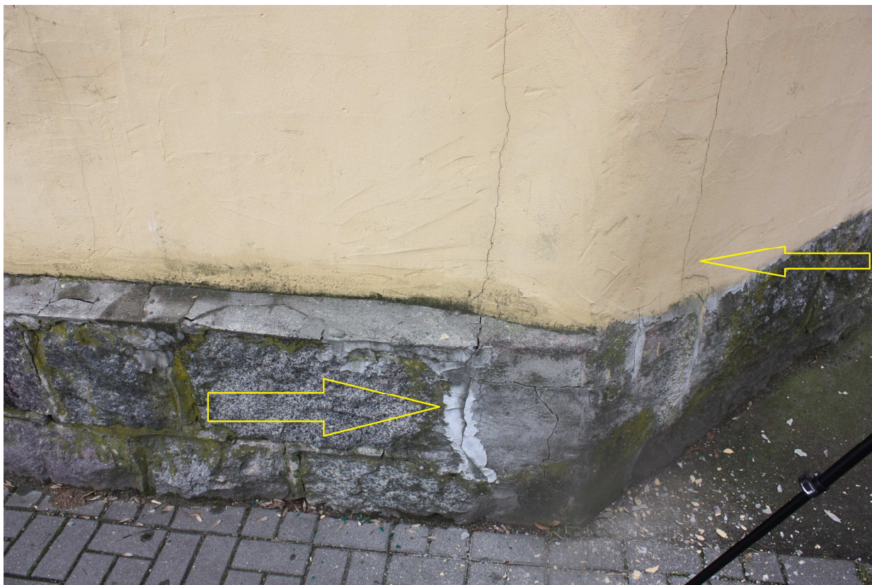
Zdjęcie nr 16 – Pęknięcia fundamentu podstawy słupa tarasu
