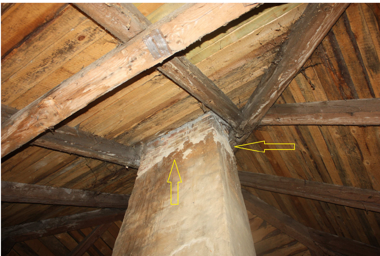
Zdjęcie nr 31 – Zawilgocenie i korozja komina na części A
