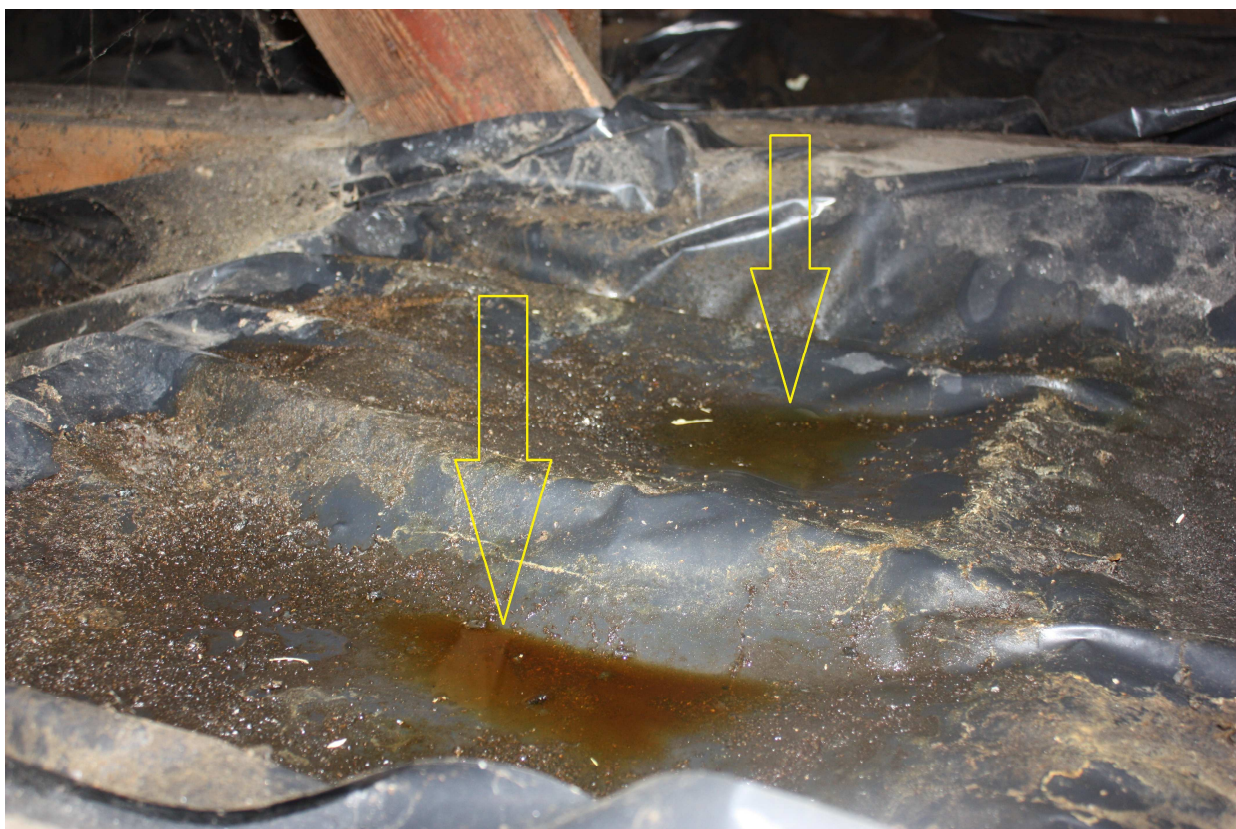
Zdjęcie nr 33 – Zastoiska wody na „poddaszu” wieży spowodowane nieszczelnym pokryciem
