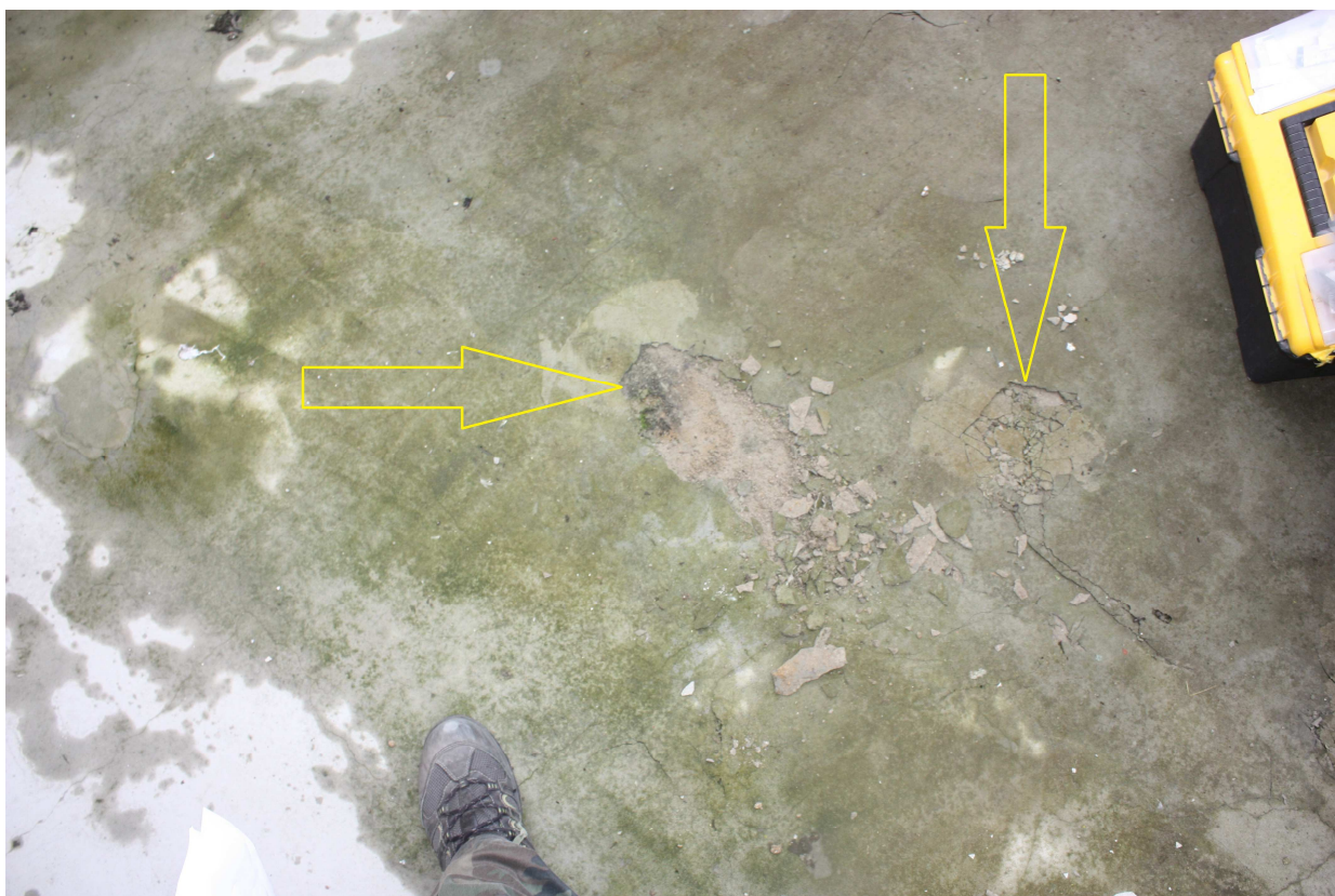
Zdjęcie nr 14 – Pęknięcia warstwy spadkowej na tarasie
