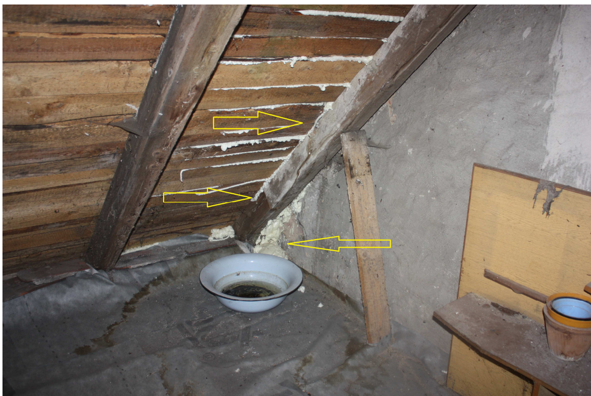
Zdjęcie nr 29 – Zacieki na połaci oraz korozja więźby na części A spowodowane błędnym wykonaniem obróbek
