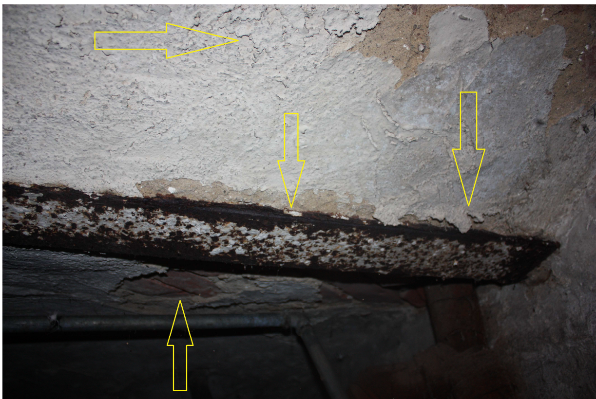
Zdjęcie nr 02 – Korozja stropu odcinkowego w części A
