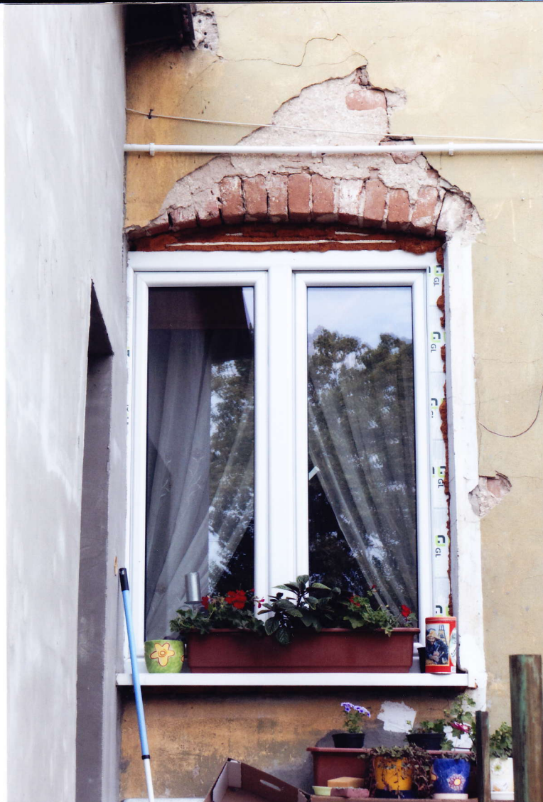
Fot. 21. Elewacja wschodnia, odkrywka nr 5 . Podczas wymiany okna okazało się, że pierwotnie otwory okienne miał inną formę – prostokąta zamkniętego od góry łukiem odcinkowym.
