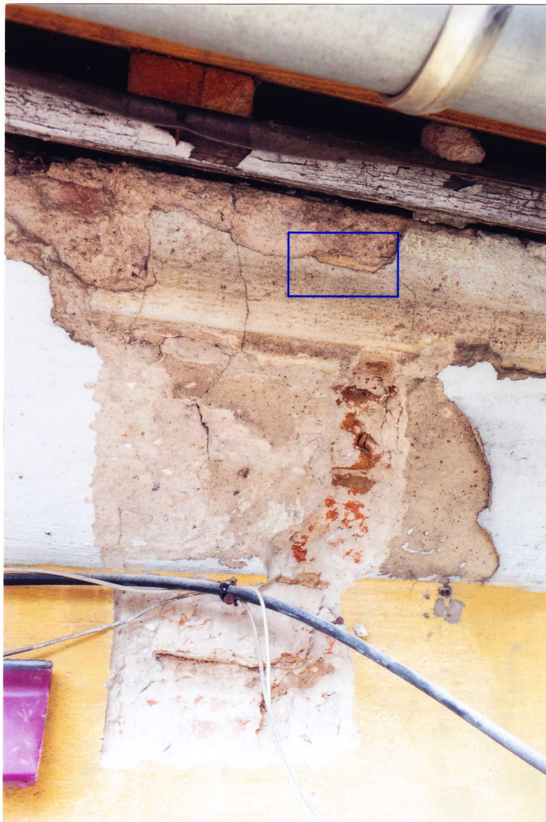
Fot. 6. Odkrywka nr 1 na gzymsie w elewacji południowej – podwórzowej. Ramką zaznaczono miejsce, gdzie zachowały się najstarsze warstwy malarskie.
