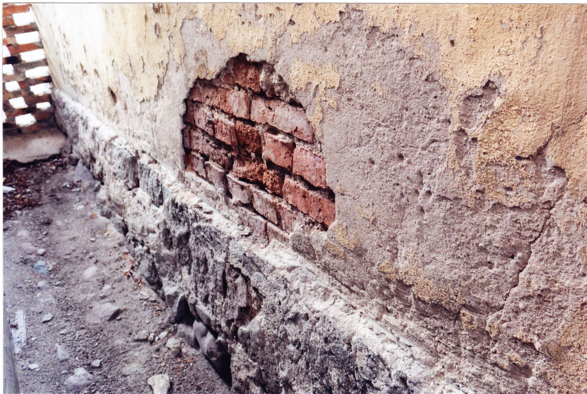
Fot. 28. Elewacja południowa w odległości ok. 1 m sąsiaduje z kolejnym budynkiem. Widoczne ubytki tynku odsłaniające kamienny cokół oraz zniszczenia tynku i złuszczoną emulsyjną powłokę malarską.
