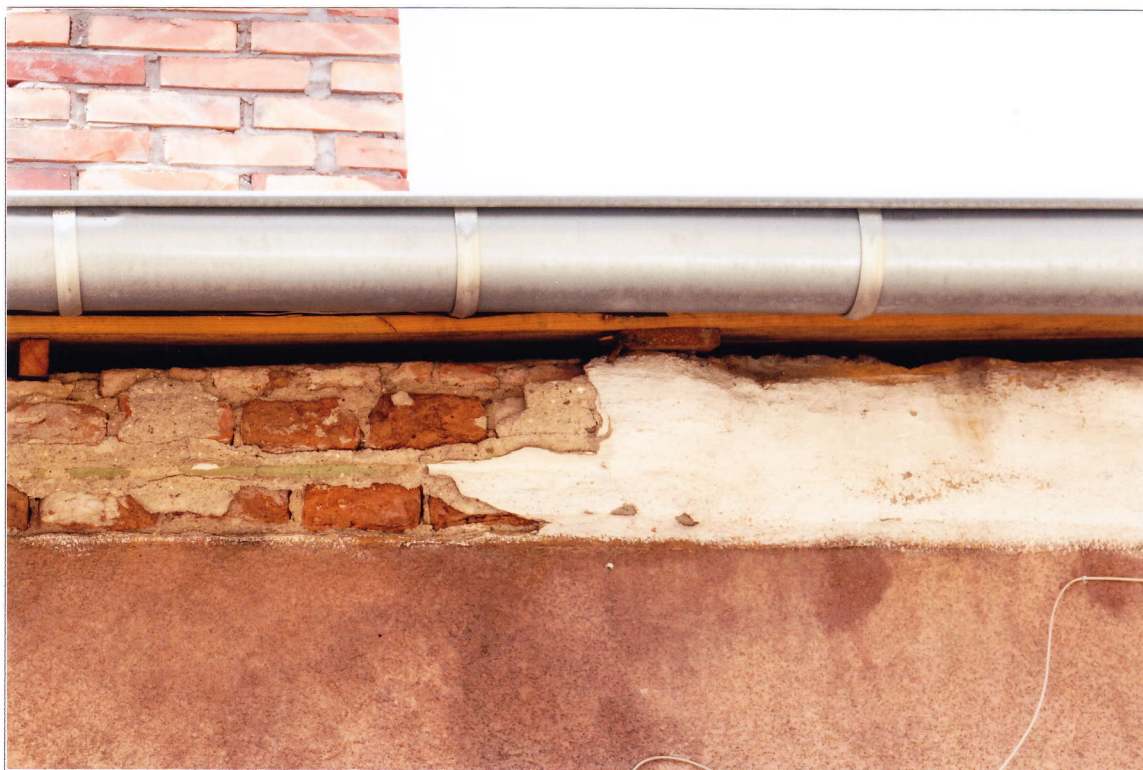
Fot. 18. Gzyms koronujący na elewacji południowo-wschodniej (podwórzowej). Widoczne relikty profilu (najprawdopodobniej już wtórnego) oraz pokrytą wtórnym tynkiem część pozbawioną pierwotnej formy. Zapewne w wyniku uszkodzonej rynny i zalewania korony muru cegły oraz tynk budujący profil uległy destrukcji.
