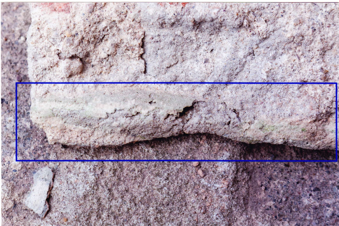
Fot. 22. Odkrywka nr 9. Tynk z zachowanymi relikdami boniowania jest spęcherzony (jak większość tynków na budynku). Fragment zdjętego, luźnego płata tynku z negatywem boniowania i relikdami warstw malarskich.
