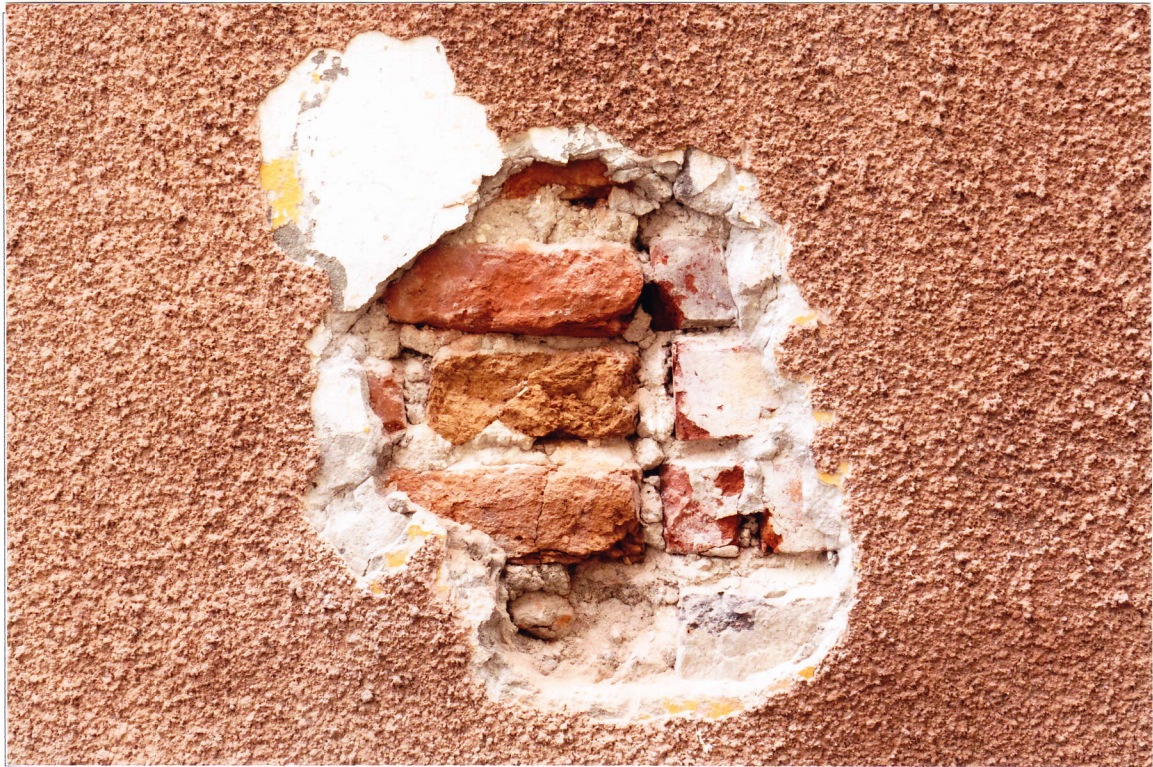
Fot. 24. Odkrywka nr 10 wykonana w miejscu pęknięcia i spęcherzenia tynku. Widoczne przemurowanie (lub zamurowanie otworu) oraz wtórne tynki.
