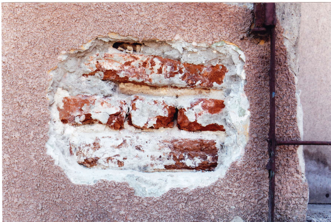
Fot. 26. Odkrywka nr 12 na elewacji południowo-wschodniej. Wtórne, cementowe tynki spowodowały uszkodzenie lica cegieł.
