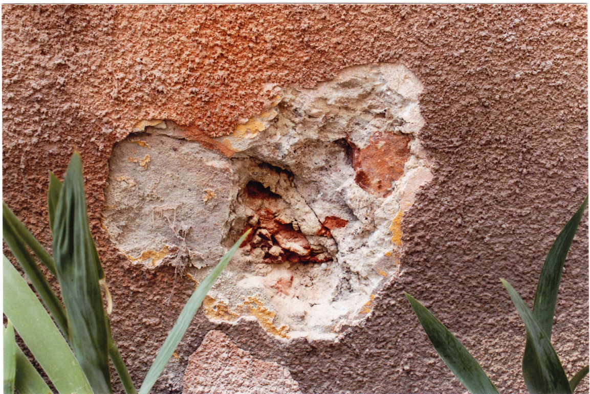
Fot. 25. Odkrywka nr 11 podobnie jak w przypadku odkrywki nr 10 wtórny, cementowy tynk położono na przemurowanie lub naprawę. Widoczne zniszczenia lica cegieł.
