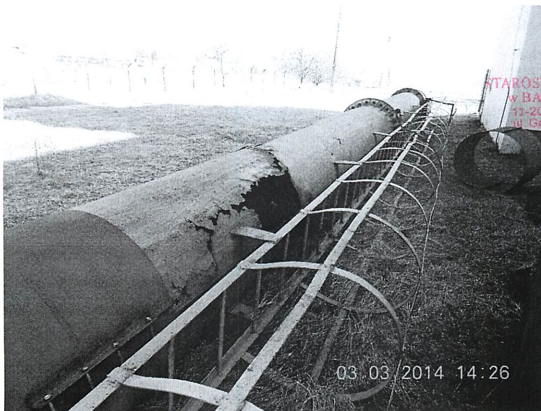
Fot. 1 Zużyty technicznie płaszcz komina stalowego
