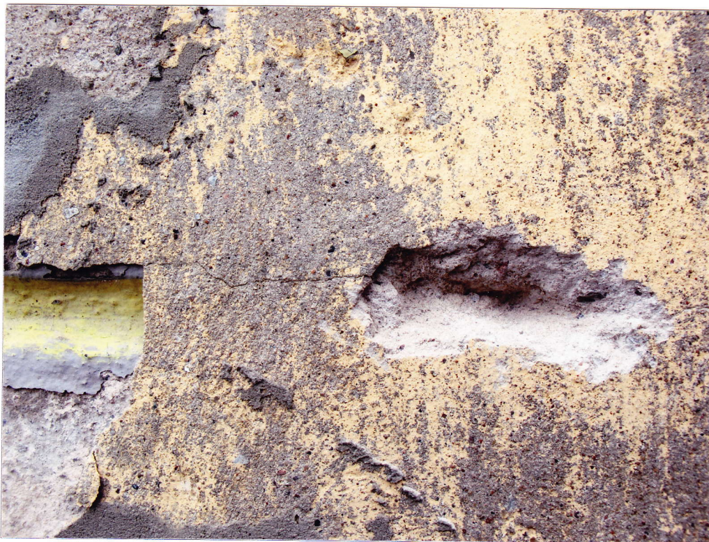
Fot. 10. Fragment odkrywki nr 14 . Widoczne wtórne powłoki emulsyjne (szare z żółtym podkreśleniem) oraz wtórny tynk, którym przykryto bonie
