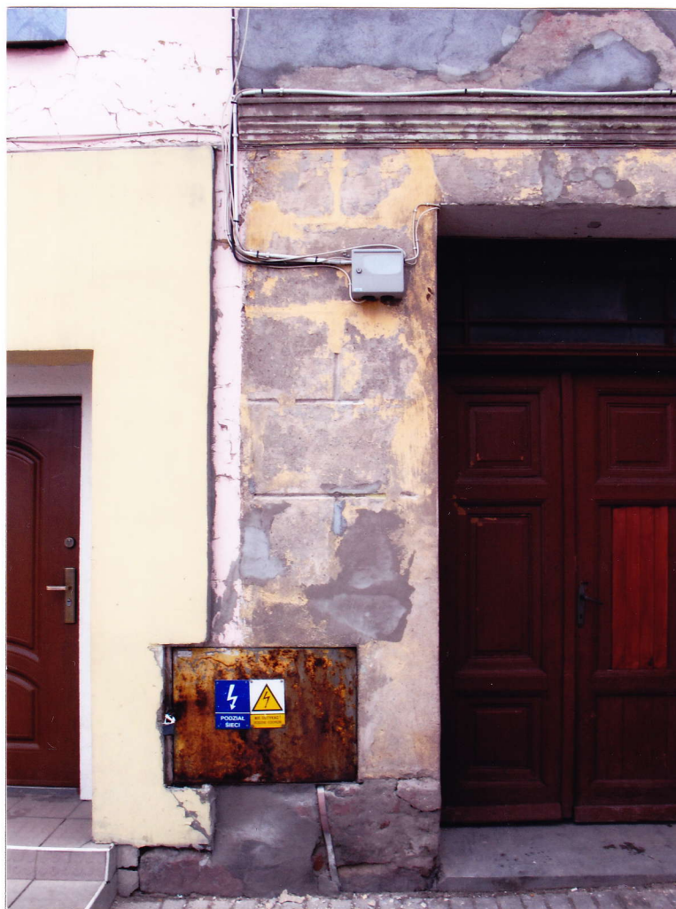
Fot. 9. Zachowane fragmenty boni w obrębie parteru po lewej stronie drzwi – odkrywka nr 14
