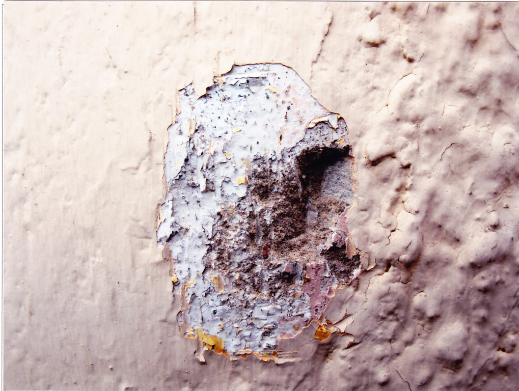
Fot. 18. Odkrywka nr 12 – opaska okna sklepowego na parterze. Gruba warstwa cementowej wyprawy (podobnie jak na ścianie obok w odkrywce nr 11 ) świadczy o zmianach w obrębie otworów okiennych i drzwiowych na parterze
