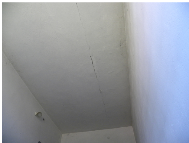
Fot.2. Charakterystyczne zarysowanie podłużne stropu
