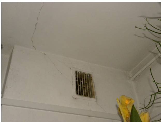
Fot.6. Zarysowanie trzonu wew.
