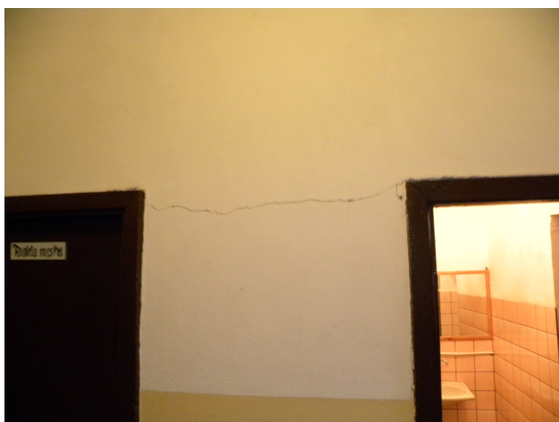
Fot.4. Rysa pozioma ściany nośnej
