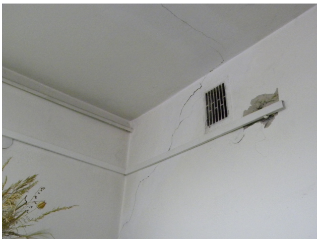
Fot.7. Zarysowanie trzonu wew.
