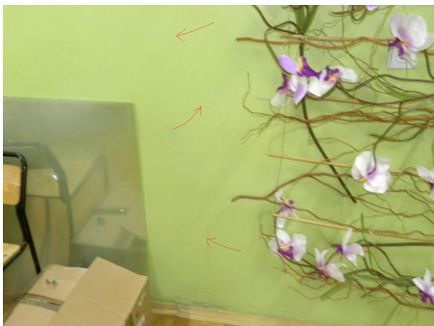
Fot.5. Rysa pionowa ściany nośnej
