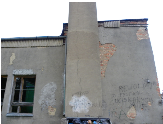
Fot.8. Zarysowanie trzonu zew.
