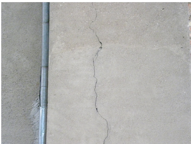
Fot.9. Zarysowanie trzonu zew.
