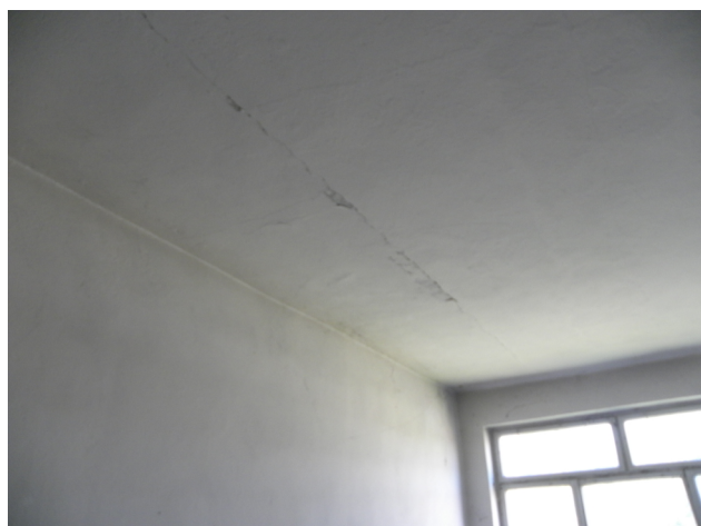
Fot.3. Charakterystyczne zarysowanie podłużne stropu
